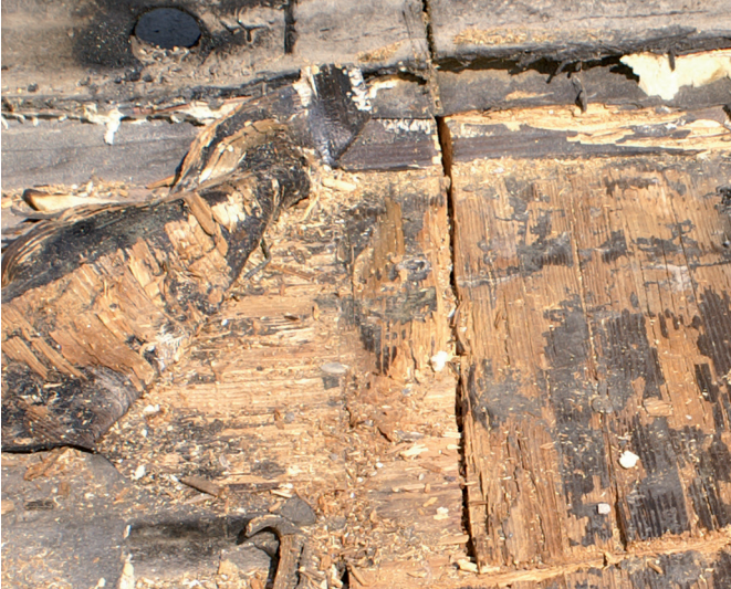
Fig. 3: Image de dégât Condensation secondaire par migration d'humidité résiduelle
