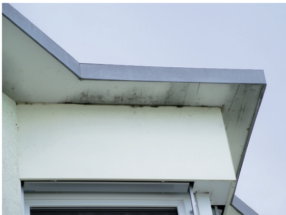
Fig. 5: Image de dégât
