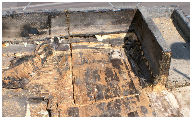
Fig. 1: Image de dégât
